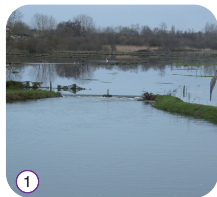
1 Sur cette photo, les travaux sont déjà réalisés. Les digues latérales permettent le maintien du niveau d'eau adéquat sur la barthe.
