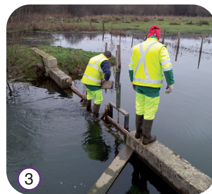
3 La fermeture du seuil pelle permet l'ennoiement de la barthe. Sa gestion concertée doit être calée sur la période de reproduction du brochet.
